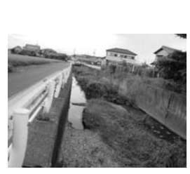
土砂堆積の井堰川
